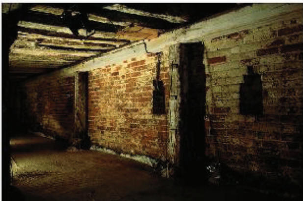
Abb. 4 Lange Straße 75. Über die Holzbalkendecke des Kellergeschosses konnte der Großteil der nischengegliederten Umfassungsmauern dendrochronologisch in die Zeit um 1283 datiert werden. Foto: A. Lutze
