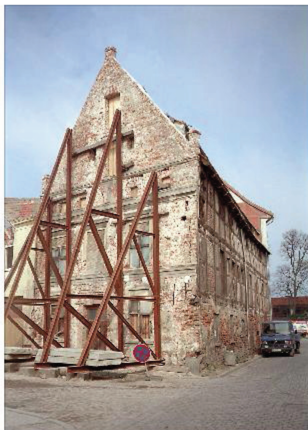
Abb. 2 Kuhstr. 25, Ecke Mühlenstrasse. Vor der Sanierung. Aufwändige Sicherung des Giebels. Foto: Musloff
