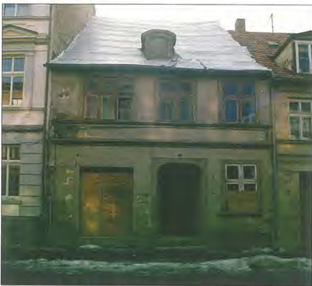
Abb. 1 Greifswald, Joh.- S.- Bach- Str. 20, Zustand der strassenseitigen Fassade im Dezember 1995, Foto: H.- H. Bär
