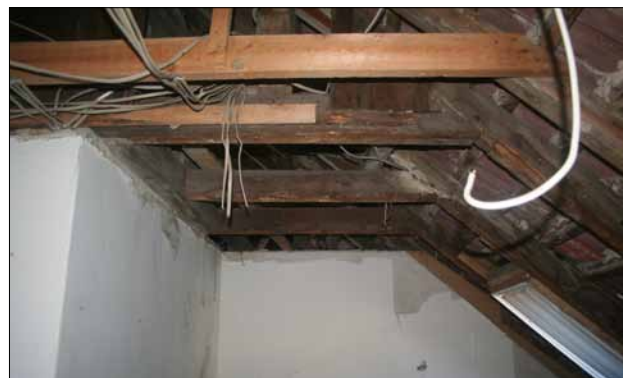
Abb. 23 Greifswald, Baderstraße 24. Mittlerer Dachbereich des ehemaligen Polizeigefängnisses. In der Bildmitte die Gebinde der schon 1879 ohne Stuhl errichteten Konstruktion aus Sparrenpaar und Kehlbalken. Blick nach Süden. Foto: D. Brandt (2017)
