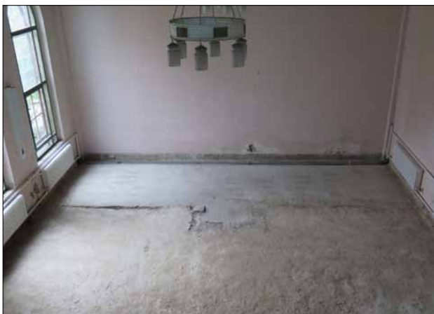
Abb. 17 Greifswald, Lutherhof. Saal von innen. Der Bereich der ehemaligen Bühne an der Ostseite des Raumes war ursprünglich unterkellert. Bei den jüngsten Sanierungsarbeiten wurden die Umrisse des Kellers und seines Treppenabganges (Mitte) freigelegt und die nachträgliche Betondecke entfernt. Blick nach Osten. Foto: R. Neumann (2016)
