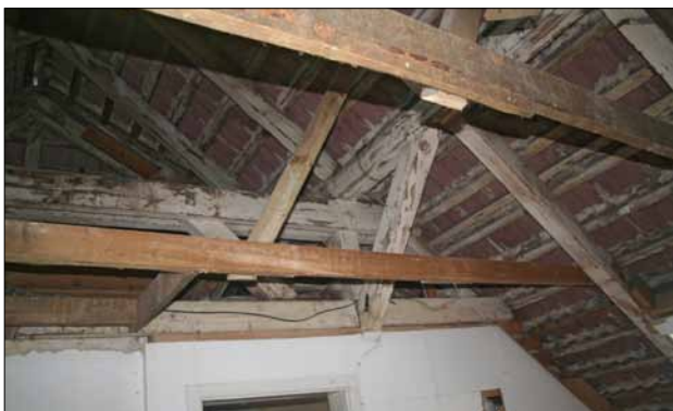
Abb. 22 Greifswald, Baderstraße 24. Südliches Dach des ehemaligen Polizeigefängnisses. Die weiß getünchten Hölzer gehören zur Pfettenkonstruktion von 1879, mit angebolzten Zangen und kopfbandverstrebt Säulen. Blick nach Südwesten. Foto: D. Brandt (2017)
