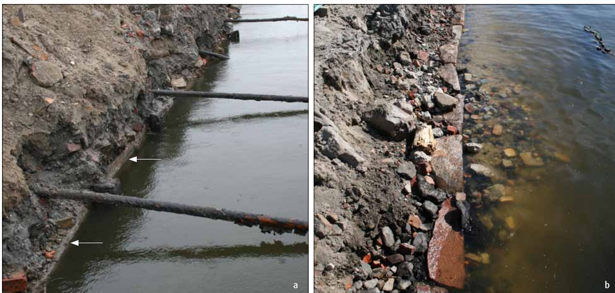
Abb. 11 Greifswald, Wieck/Eldena. Uferbefestigung auf der Wiecker Seite des Ryck-Flusses. Auf eingerammten Pfosten waren zunächst Längsunterzüge (a, siehe Pfeile) und darauf Granitquader (b) verlegt (vgl. Abb. 12). Fotos: P. Kaute (2011)
