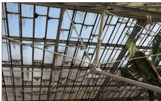
Abb. 26 Greifswald, Münsterstraße 2. Zentrales Palmenhaus der großzügigen Gewächshausanlage. Blick nach Nordosten auf die aus Puddelstahl und Schmiedeeisen bestehende Dachwerkskonstruktion nach dem Wiegmann-Polonceau-Prinzip. Foto: T. Weiß (2017)
