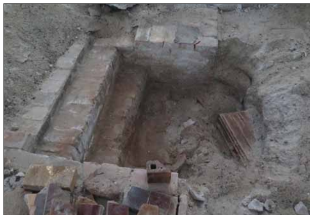
Abb. 18 Greifswald, Lutherhof. Saal von innen. Treppenabgang in den Keller unter der ehemaligen Bühne an der Ostseite des Raumes (vgl. Foto 17, dort Mitte). Die Unterkellerung war ursprünglich angelegt, wie auch ein zugemauertes Fenster auf der Hofseite beweist. Blick nach Nordwesten. Foto: R. Neumann (2017)
