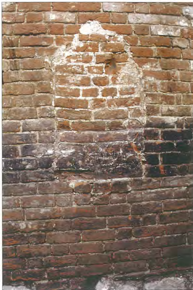
Abb. 31 Hansestadt Greifswald, Lange Straße 49, Westgabelmuer, Detail zu Abb. 30. Auf Grund des Mauerverbandes und erhaltener Befunde konnten die zugesetzten Bereiche als rundbogig geschlossene westliche Öffnungen innerhalb größerer und mit geraden Laibungen auf der Mauerostseite ausgeführter Nischen rekonstruiert werden (vgl. auch Abb. 11, dort jedoch mit Schrägläibungen in der Südquerhauswestmuer). Foto: A. Lutze
