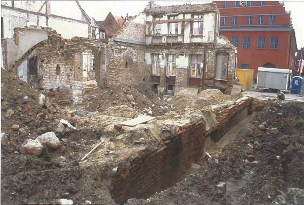
Abb. 37 Hansestadt Greifswald, Markt 28. Der Überblick von Südwesten zeigt den im Jahre 2002 freigelegten mittelalterlichen Baubestand des ursprünglich giebelständigen Backsteingebäudes von ca. 1285/90. Im Bereich des Kellers waren beide Längsmauern fast vollständig erhalten, die Grenzmauer zu Nr. 29 enthielt auch im Erdgeschoss mittelalterliche Bauteile. Deren südliche Wandflächen waren ursprünglich durch verschiedenste Nischenformen gegliedert. Foto: A. Lutze
