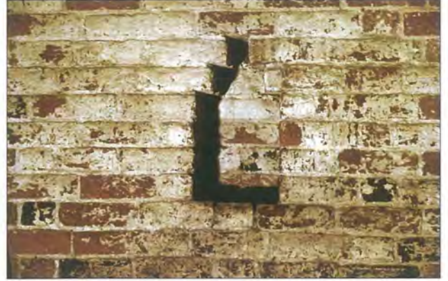
Abb. 33 Hansestadt Greifswald, Lange Straße 75, Kellergeschoss, Brandmauer zu Nr. 77. Auf der Westseite der um 1283 (d) errichteten Mauer sind vier Steinlagen hohe und zweifach abgetreppt schließende Nischen ausgeführt. Die gleiche, ebenfalls mehrfach wiederholte Form findet sich in regelmäßiger Verteilung auch auf deren Ostseite. Foto: A. Lutze
