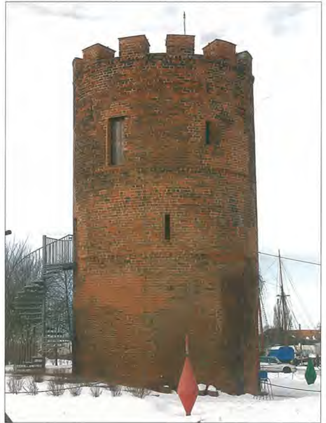
Abb. 22 Hansestadt Greifswald, Stadtmauer, so genannter Fangenturm, von Südosten. Der nordöstliche runde Eckturm der ältesten massiven Stadtbefestigung zeigt auch nach seiner Sanierung in den 1990er Jahren noch wesentliche bautechnische und formale Merkmale, die eine Entstehung in der Zeit 1270/80 nahe legen. Dazu gehören neben den umlaufenden geschosstrennenden Sägezahnfriesen auch das Backsteinformat und die im Turminnen sichtbaren Nischen mit Treppensturz. Der mit der äußeren Mauerschale ausgeführte Wechselverband ist grundrissbedingt: Gerundete Bauteile ließen sich besser mit vermehrter Binderverwendung ausführen. Ob die heutige Zinnenbekrönung auf den ursprünglichen Bestand zurückzuführen ist, kann bisher nur vermutet werden. Foto: D. Brandt
