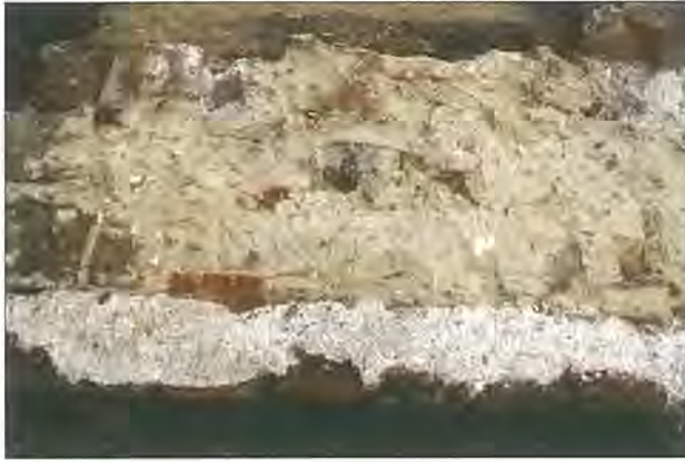
Abb. 9 Hansestadt Greifswald, Mühlenstraße 8 / Ecke Brüggestraße, Kellergeschoss, Westmauer (um 1285/90), Aufsicht. Der Mauerkroneauschnitt zeigt eine farblich sehr deutlich erkennbare Unterscheidung zwischen einem festen weißen Schalenmörtel (unten) und einem weicheren gelben Mörtel für den Mauer Kern. In dieser klaren farblichen Differenzierung lässt sich die so genannte Mörtelunterscheidung für Mauerzüge ab der Zeit um 1260 (Ostflügel Klostersruine Eldena) beobachten (zunächst bis 1320/40, danach ist die Trennung eher über die Mörtelkonsistenz möglich).
