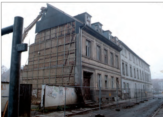
Abb. 5 Greifswald, Domstraße 49. Im Kellergeschoss des im Jahre 2000 abgebrochenen Gebäudes konnte an der Grenze zum Seitenflügel des Eckhauses Baderstraße 3 die östliche Begrenzungsmauer einer um 1270/1280 an der Domstraße errichteten Budenzeile dokumentiert werden. Blick nach Nordosten. Foto: A. Lutze (2000)
