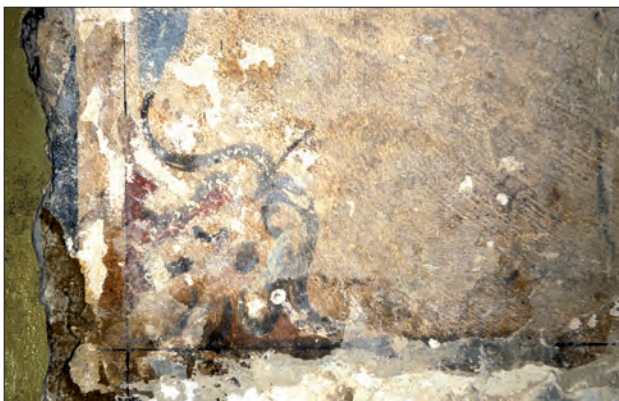
Abb. 8 Greifswald, Marienkirchplatz 1/2. Renaissancezeitliche Farbfassung auf der Fachwerktrennwand zwischen Haus Nr. 1 und 2 im vorderen Bereich des Erdgeschosses von Haus Nr. 1: Fachwerkhölzer schwarz verbreitert, begleitet von dünner schwarzer Linie auf weißem Putz; in den Feldecken schwarz-graues Blattwerk vor rotem Grund. Blick nach Osten. Foto: T. Rütz (1995)
