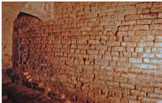
Abb. 6 Greifswald, Domstraße 49. Östliche Umfassungsmauer im Kellergeschoss einer um 1270/1280 an der Domstraße errichteten Budenzeile. Das ursprüngliche mittelalterliche Backsteinmauerwerk ist im Wendischen Mauerverband ausgeführt. Blick nach Nordosten. Foto: A. Lutze (2000)
