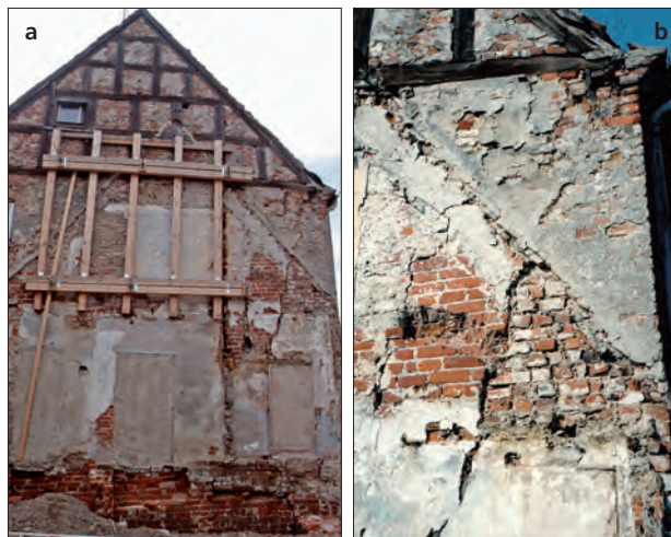
Abb. 2 Greifswald, Marienkirchplatz 1/2. Östliche Giebelmauer, Überblick (a). Foto: A. Lutze (1997). Detail Mauerwerk mit Dachspuren und sekundärem Gewölbeansatz (b). Foto: J. Chr. Holst (1997)
