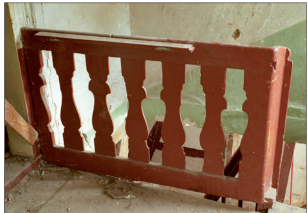
Abb. 7 Greifswald, Domstraße 52. Bis zum Beginn der 1990er Jahre gab es im Eckbau noch die ursprüngliche Treppenanlage mit balusterförmigen Brettdecken. Leider ist sie bei der wenig später ausgeführten Hausreparatur beseitigt worden. Foto: T. Rütz (1991)
