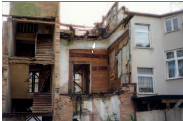
Abb. 1 Greifswald, Fleischerstraße 17. Blick nach Osten auf die ab Herbst 1993 offene Rückseite. Raum mit Resten klassizistischen Wanddekors (Pfeil), die kurz darauf verloren gingen. Foto: T. Rütz (1994)
