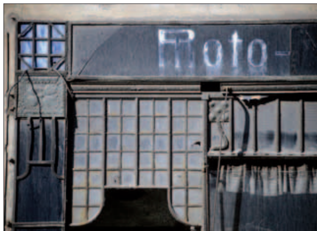
Abb. 12 Greifswald, Fleischerstraße 17. Detail der Schaufensterrahmung von 1911. Zu erkennen ist hier noch ein Teil der Werbeaufschrift eines Fotogeschäftes. Foto: T. Rütz (1993)
