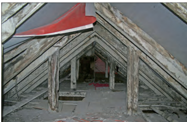
Abb. 13 Greifswald, Lange Straße 82. Oberdach des Vorderhauses. Das Lastenrad eines Aufzuges befand sich in der obersten Dachebene, die Pfosten für seine Befestigung sind bis heute erhalten geblieben. Diese Vorrichtung diente zum Warentransport durch die einzelnen Geschosse des Hauses (vgl. auch Abb. 12), dessen Dach genügend Lagerraum bot. Blick nach Osten. Foto: D. Brandt (2014)
