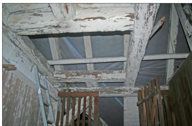
Abb. 12 Greifswald, Lange Straße 82. Windeluke im Oberdach des Vorderhauses. Ein Lastenaufzug diente dem Transport von Waren innerhalb des Gebäudes. Zu ihm gehörten solche Windeluken, die ursprünglich auch in den übrigen Geschossdecken vorhanden waren. Blick nach Norden. Foto: D. Brandt (2014)
