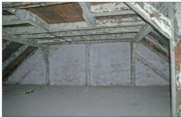
Abb. 11 Greifswald, Lange Straße 82. Östliches Drittel des Oberdachs über dem Vorderhaus. Allein der obere, flache Teil dieses Mansarddachs entspricht in seinen Dimensionen einer vollständigen Dachkonstruktion auf einem mittelgroßen Haus. Abgesehen von dem doppelten Stuhl ist am oberen Bildrand die Öffnung für einen der Schornsteine gut zu erkennen. Blick nach Osten. Foto: D. Brandt (2014)
