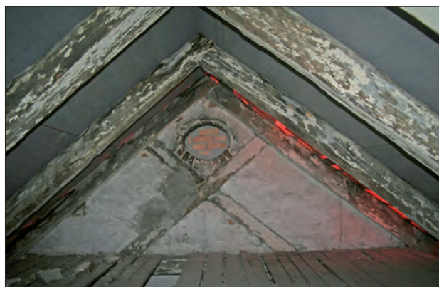
Abb. 14 Greifswald, Lange Straße 82. Blick auf die Spitze des Ostgiebels. Dieser Giebel des Vorderhauses wurde - anders als jener auf der Gegenseite und die übrigen Umfassungsmauern - nicht durchgehend massiv, sondern als verblendetes Fachwerk errichtet. In seiner Spitze sind das für die erste Hälfte des 18. Jahrhunderts typische Andreaskreuz und ein liegendes Ochsenauge zu erkennen. Foto: D. Brandt (2014)
