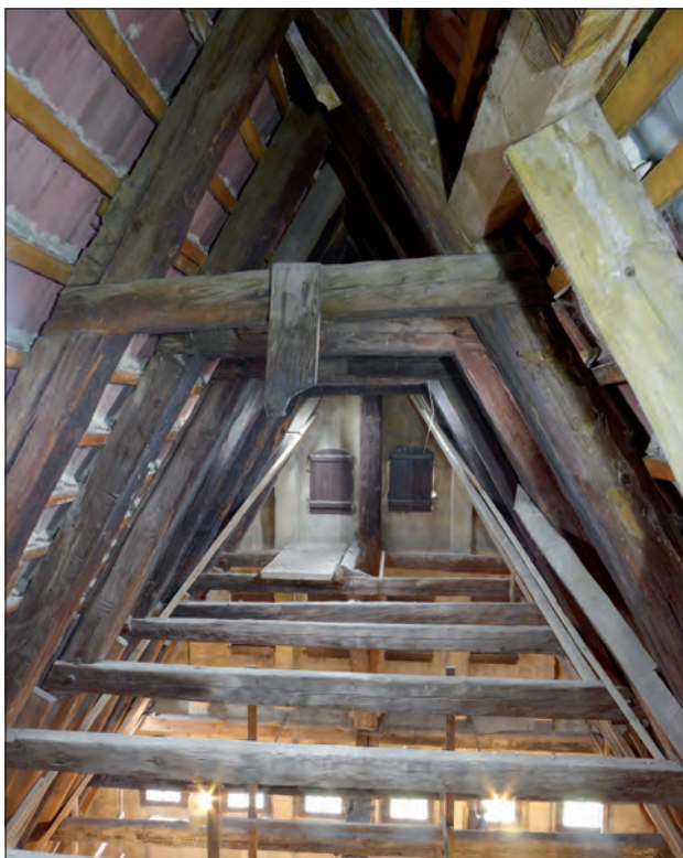
Abb. 3 Greifswald, Knopfstraße 20. Renaissancezeitliches Dachwerk aus 17 Sparrenpaaren. Im Hintergrund ist der bis zum First laufende Mittelstiel am Rückgiebel zu sehen. Blick nach Osten. Foto: T. Rütz (2015)
