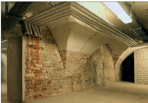
Abb. 3 Greifswald, Lange Straße 82. Kellergeschoss des Haupthauses. Die Südseite der 0,86 m dicken mittelalterlichen Nordmauer wird zu großen Teilen durch ein barockes Kreuzgratgewölbe verdeckt. Ganz links der Durchgang zum ebenfalls gewölbten Keller des an der Fischstraße gelegenen Seitenflügels. Blick nach Nordosten. Foto: A. Lutze (2016)
