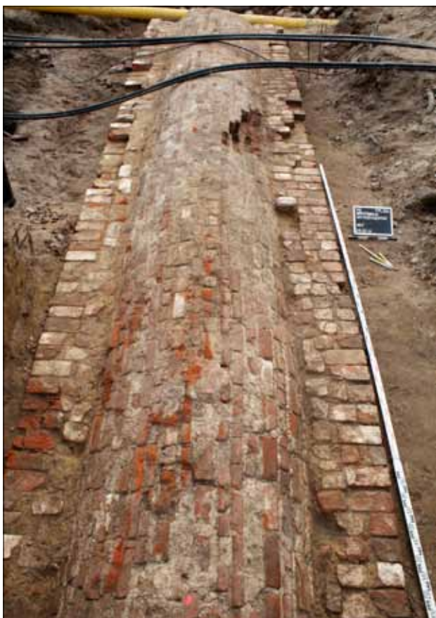
Abb. 8 Greifswald, Bereich Mühlentor. Gewölbeoberseite des um 1800/1810 östlich des Tores zur Überbrückung des inneren Stadtgrabens angelegten Kanals. Blick nach Südwesten. Foto: G. Schindler (2014)
