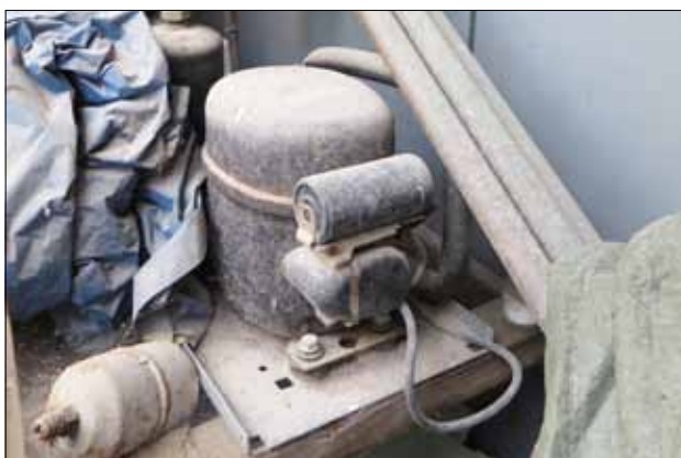
Abb. 16 Greifswald, Bahnhofstraße 6. Blick nach Südosten in den Hinterhof des Grundstücks (oben). In den Anbauten an der östlichen Grundstücksgrenze ist eine Kältemaschine teilweise erhalten (unten). Mit ihr produzierte die HO Speiseeis für die im Vorderhaus eingerichtete Eisdiele und für weitere Läden in Greifswald. Fotos: R. Neumann (2016)
