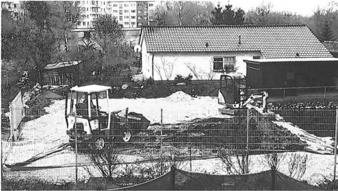
Abb. 6: Fortsetzung illegaler Baumaßnahmen auf der privaten Grünfläche (23. April 2018).
