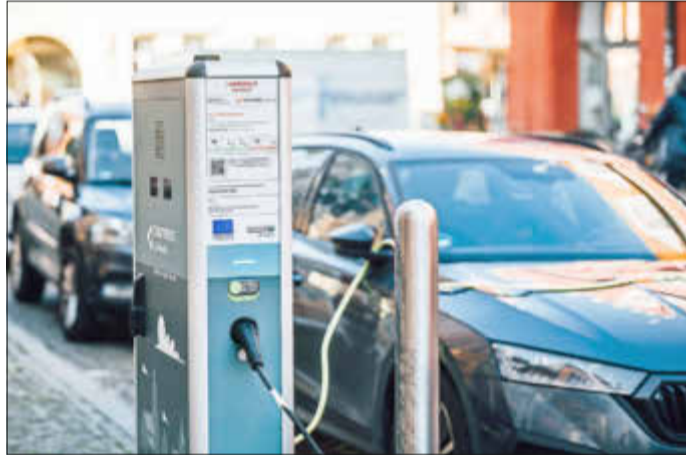
Ladesäule für E-Autos vor dem Rathaus
